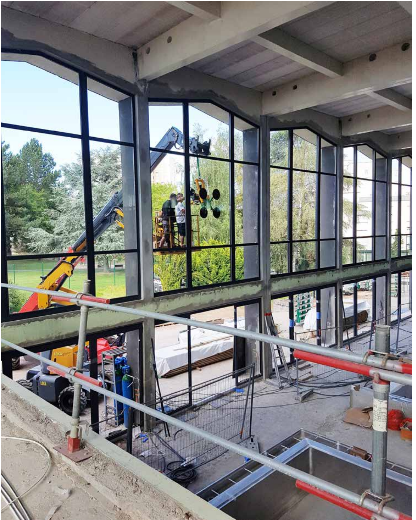
Dernière étape de la pose des baies vitrées réalisée à l'aide d'un élévateur.
