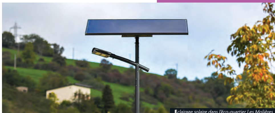
Eclairage solaire dans l'éco-quartier Les Molières
